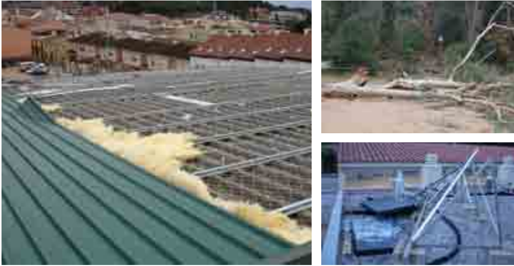
Detall del sostre del pavelló, arbre caigut i plaques solars arrencades, després del temporal.
